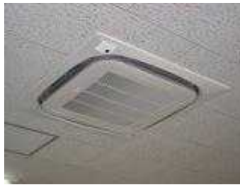
〔天井に取り付けられたエアコン〕
